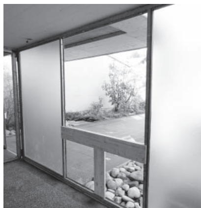
Eingeschlagene Scheibe beim Schulhaus
