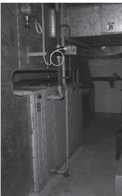
Technik Lüftung im UG
